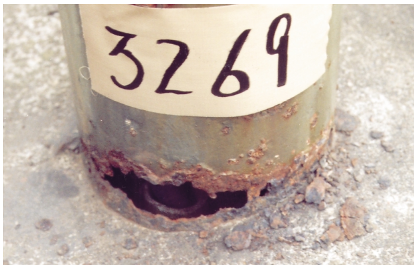
▲ 地際部が錆び、孔が開いた状態
