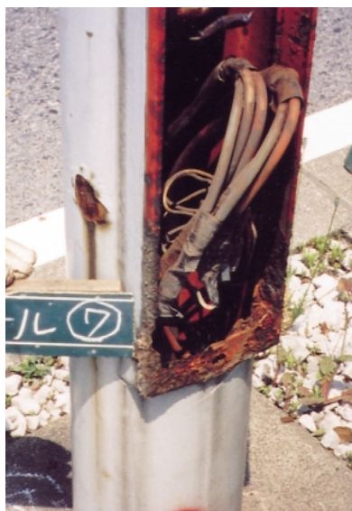
▲ 開口蓋を外した状態
