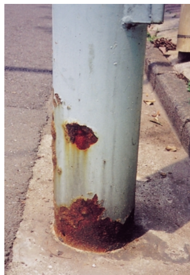
▲ 地際部 犬の尿により錆びた状態
