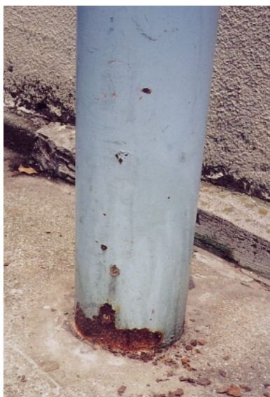
▲ 地際部 犬の尿により錆びた状態
